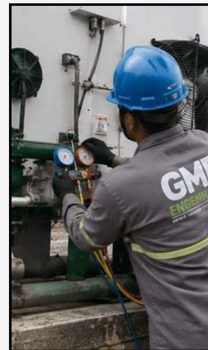
Inspeção e Diagnóstico de Sistemas de Refrigeração
